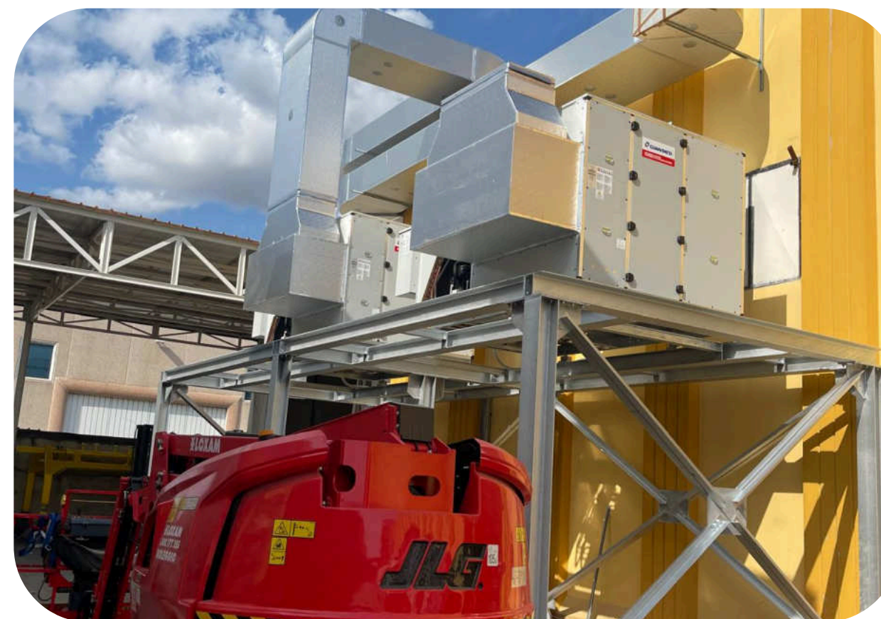
Impianto termico di tipo Industriale A.M.S.(CE)
